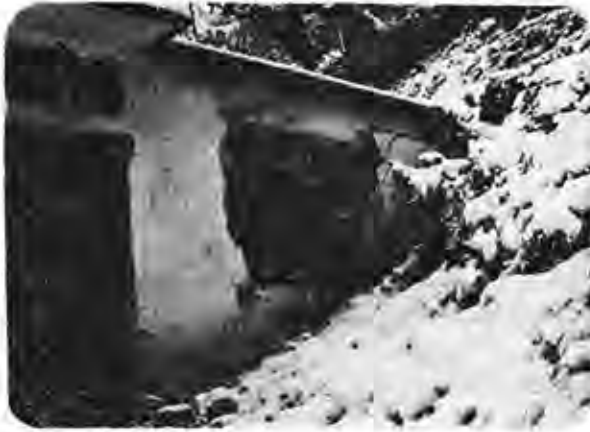
Foto 5 — Heyelanın taç kısmındaki binada oluşan çatlaklar.
