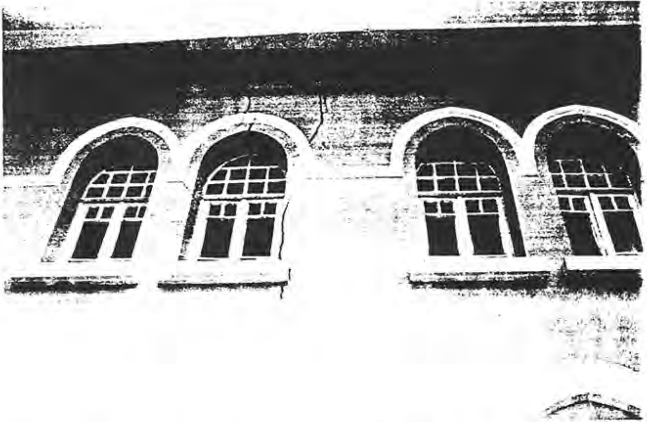
Şekil 3- Kısıklı Abdullah camisinde zemin titreşimlerinin sebep olduğu çatlamlar
