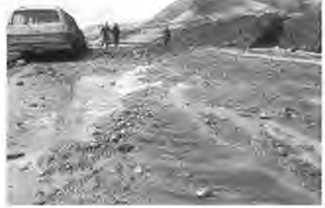
Şekil 6. Heyelan nedeniyle kapanan I-15 otoyolu (Fotoğraf: C. Finley).
