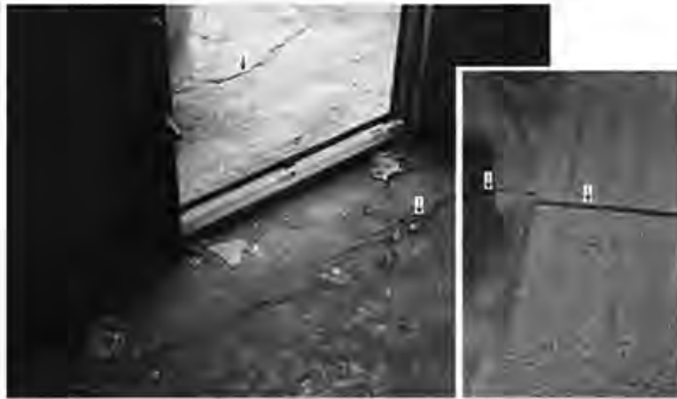
Şekil 10. Kuzey yolcu salonu batı duvarına paralel yapı döşemelerinde ve kaldırımında oluşan çatlaklar.
