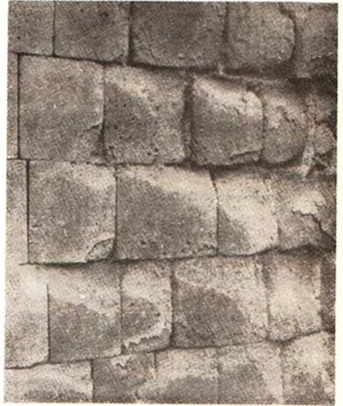
Şekil 7: İnce elemanlı kumtaşlarında yüzeysel ayrışmaya bağlı kabuk oluşumu (R. MANARESSI'den 1976).
